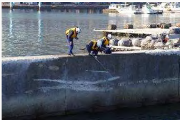
衝突によって損傷した防波堤
