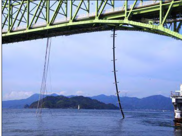
衝突後の橋の様子
