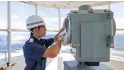
⑦ 奄美大島最北端の断崖の上に設置されている笠利埼灯台の維持管理に向かう職員。ハブが生息しているため、棒などで威嚇しながらアプローチする。 ⑧ 笠利埼灯台では風光風速計や灯器に異常がないかをチェックする。
